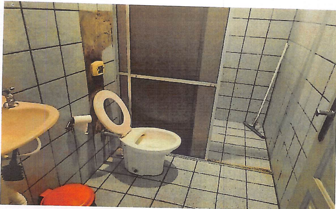
Foto 5: Outra vista interna do banheiro com danos no azulejo da fiada da descarga.
